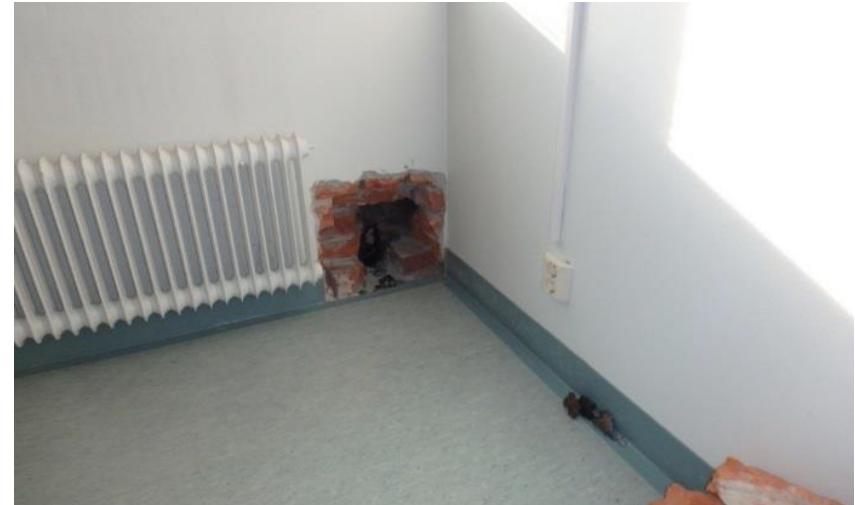
Kuntotutkimuksen tyypillinen rakenneavaus ulkoseinän alaosassa, jolla tutkittiin tuulettumattoman tiili-villa-tiili –rakenteen eristeen kuntoa.
