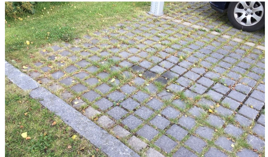
Pysäköintipaikkojen nurmikiveys auttaa osaltaan hulevesien hallinnassa. Kuva Tampereen kaupunki 2019.
