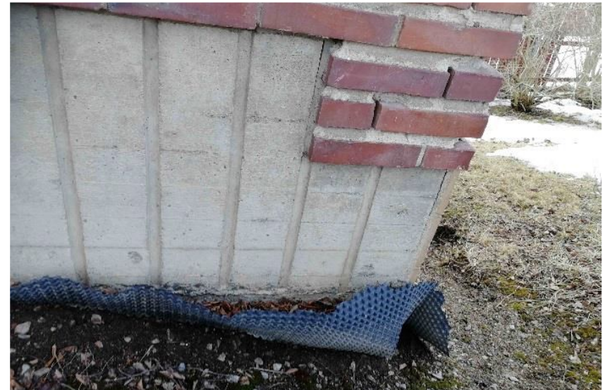
Patolevy liian pitkänä ohjaa vettä perusmuuria vasten ja kastelee rakenteita. Kuva Kuntoselvitys RKM Group Oy 2019.
