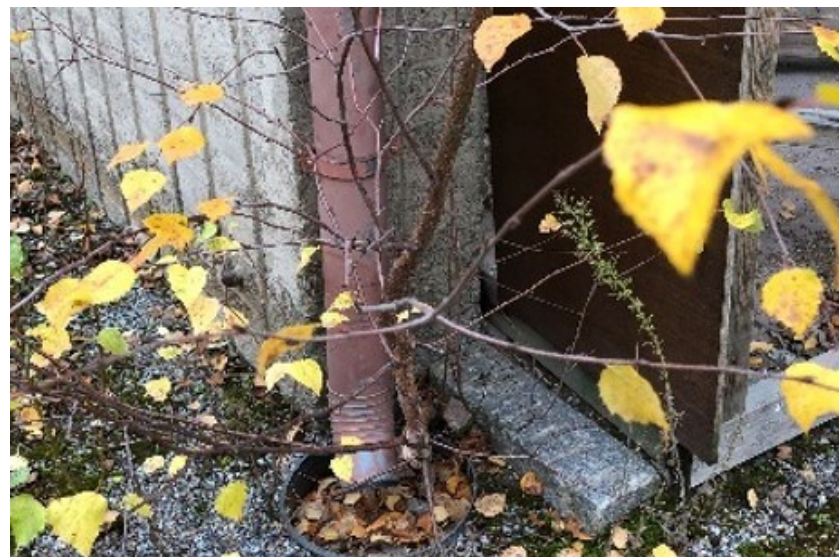
Vanhat sadevesijärjestelmät kaipaavat huoltoa. Kuva Tampereen kaupunki 2021.
