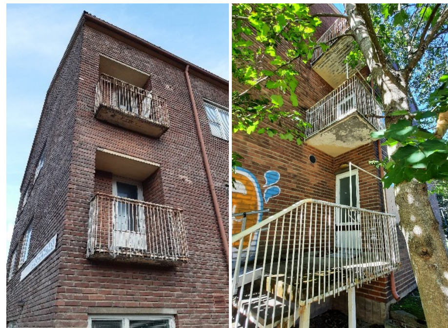
Lastentalon parvekkeet kaipaavat huoltoa. Kuvat Tampereen kaupunki 2021 ja 2022.
